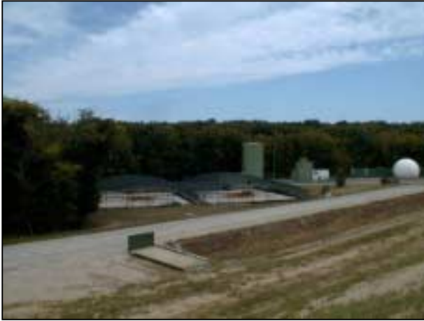
Photographie 5 : bassins d'aération pour les lixiviats
