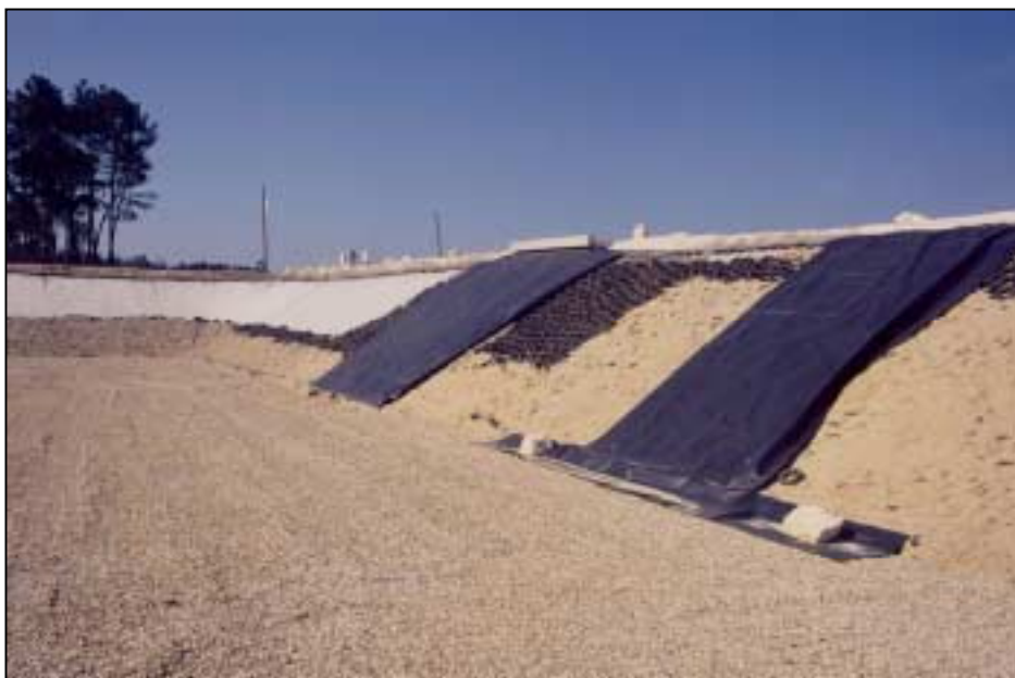
PHOTOGRAPHIE 4 : ELABORATION DE LA SECURITE ACTIVE (DE BAS EN HAUT : GEOTEXTILE SUPPORT, GEOMEMBRANE EN PEHD, GEOTEXTILE ANTIPOINÇONNANT, MASSIF DRAINANT)
