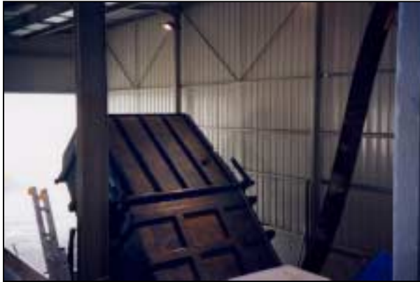
Caisson de réception des boues de station d'épuration
