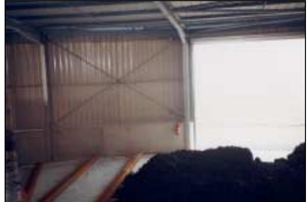
Alvéole pour fermentation , rails d'aération apparents (enceinte couverte)
