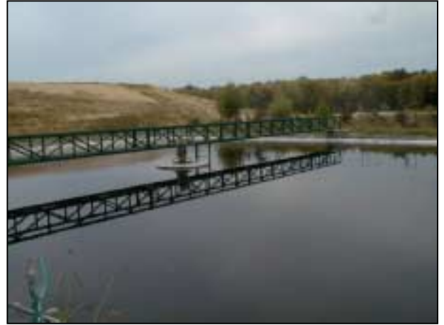
Photographie 6 : lagune pour les lixiviats
